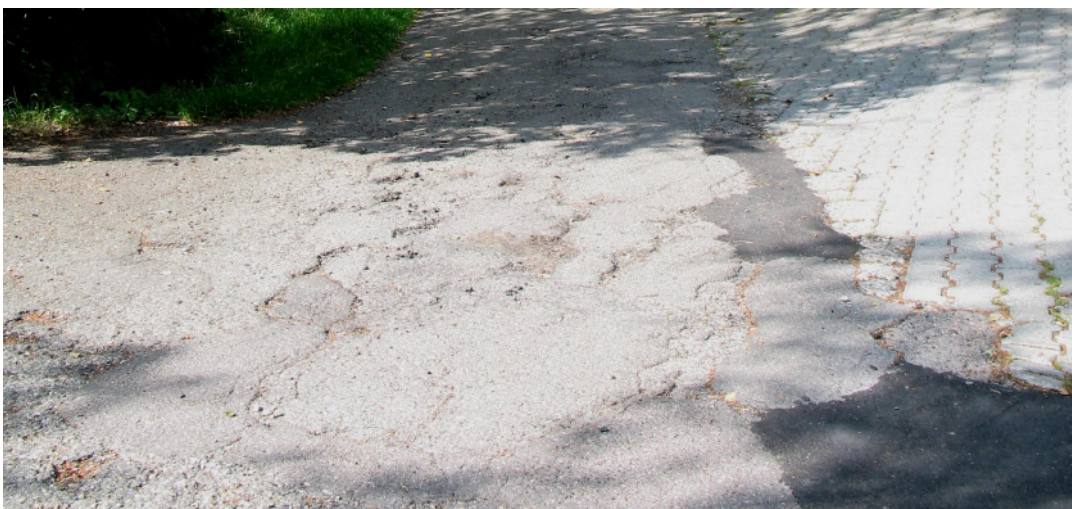
Abb. 15: Beschädigter Fahrbahnbelag nahe des Zollberger Friedhofs
