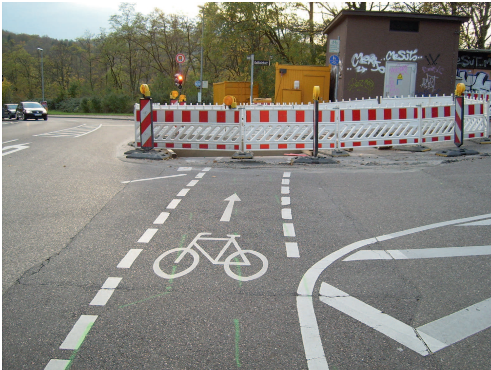
Mangelhaft Berücksichtigung des Radverkehrs an einer Baustelle
